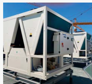
Cédrus Liget Hungría. Un complejo que incluye apartamentos, oficinas y unidades comerciales. Szeged, Hungría. ECOi-W, ECOi y ventilación de recuperación de energía.
